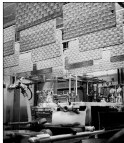
Schallschirm in einer Getränkeabfüllanlage
